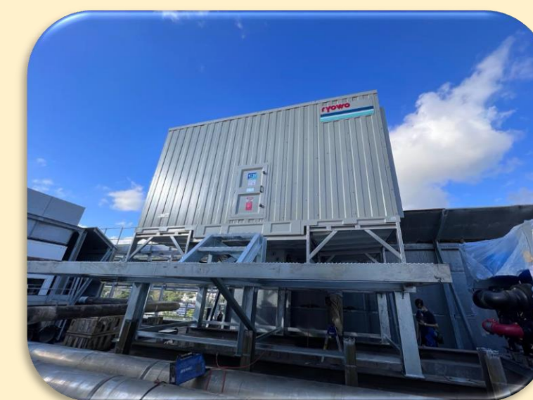
圖20：教育局九龍塘教育服務中心 在二零二二年把氣冷式製冷機更換為水冷式製冷機
